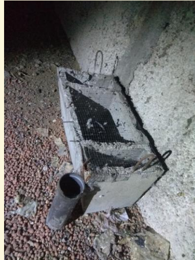
Вихід вентиляційного каналу на тех. поверх («тепле горіще»)
